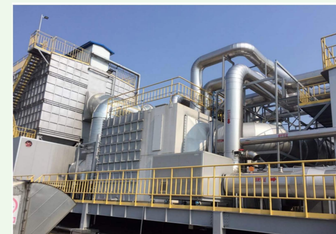
废气处理设施
