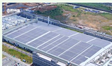
公司屋顶光伏发电装置
